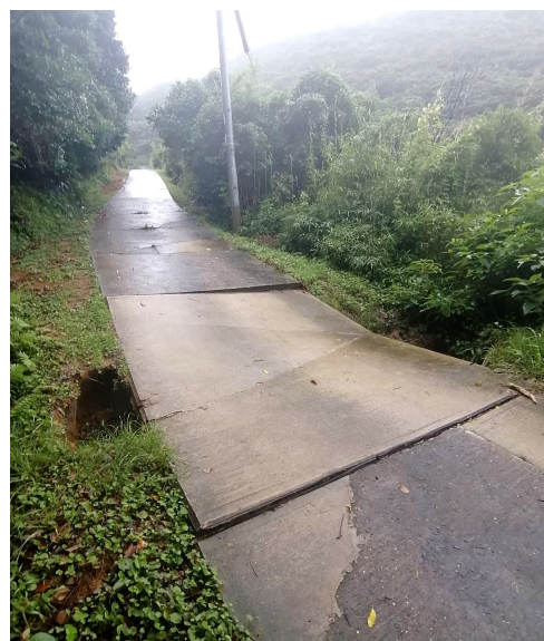
7月 大小瀬陥没箇所
