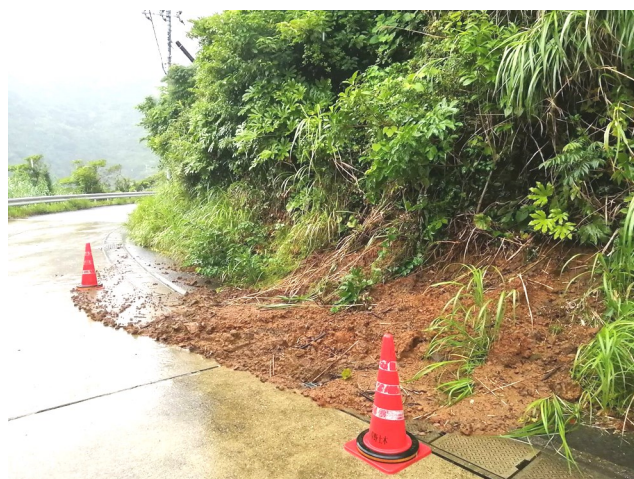
6月 計6カ所が崩れた
