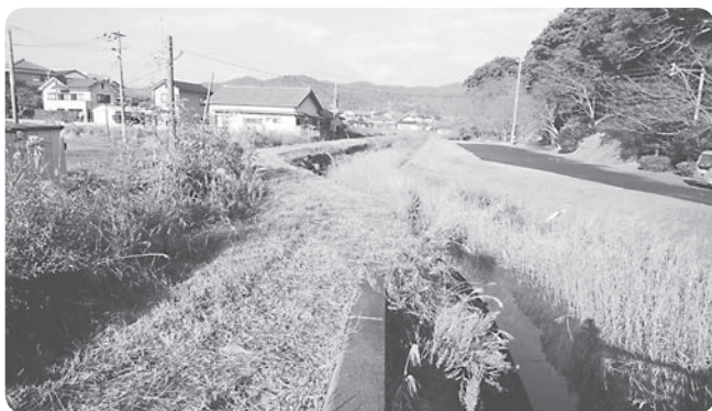
早急な補修が待たれる田部手川護岸
