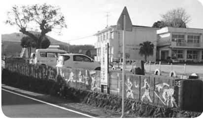
学校に設置されているブロック塀
