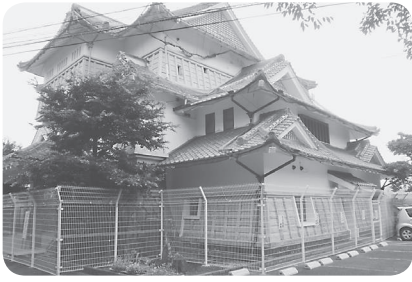
施設の老朽化が進んでいる現在の図書館
