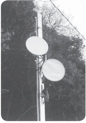
久賀島に設置されている無線機
