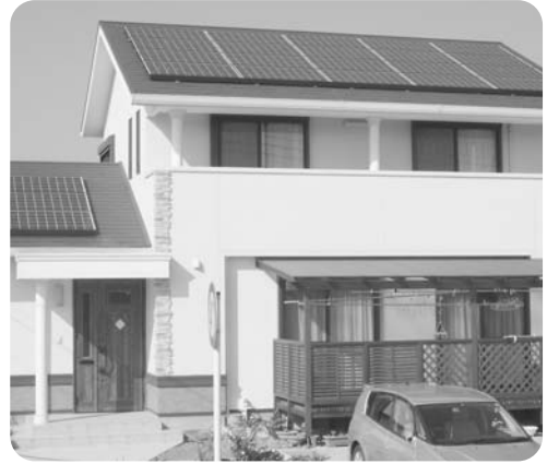
住宅用太陽光発電設備
