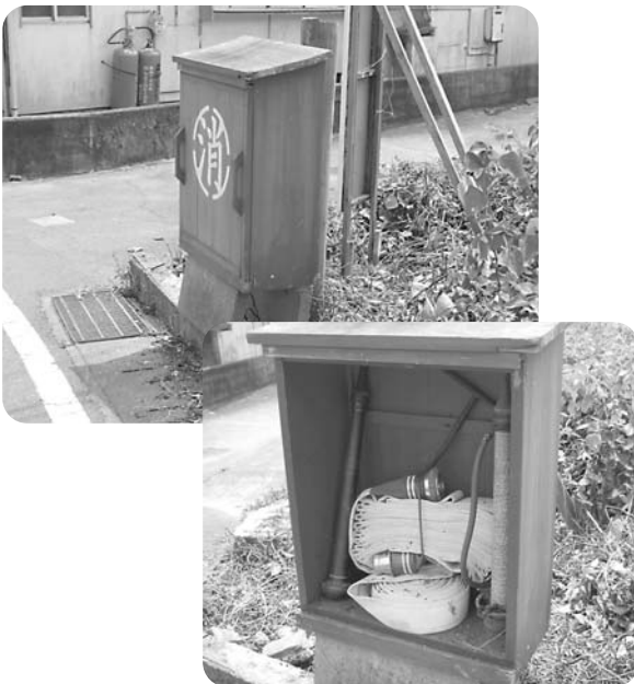
玉之浦地区の消火栓用消防ホース格納箱
