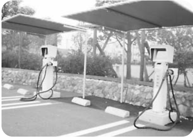
大波止に設置されている急速充電器
