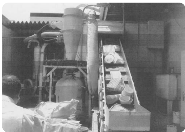
環境創造舎の廃プラ油化還元装置
