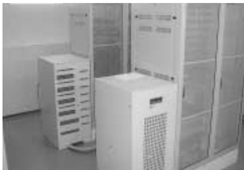
市民体育館に移設した設備
