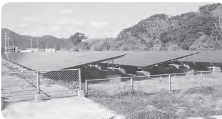
太陽光発電施設
