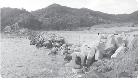
消波ブロックが崩壊した黒瀬漁港(琴石地区)
