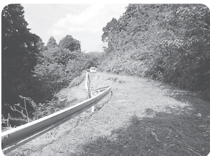
林道佐舗坂ノ上線の被害状況
