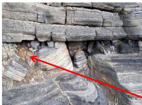
写真E-14 火山噴出物中の地層が割れた部分
