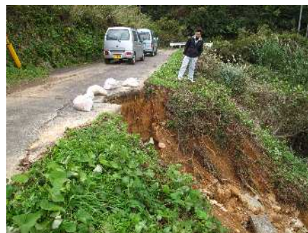
大雨による斜面の崩落
