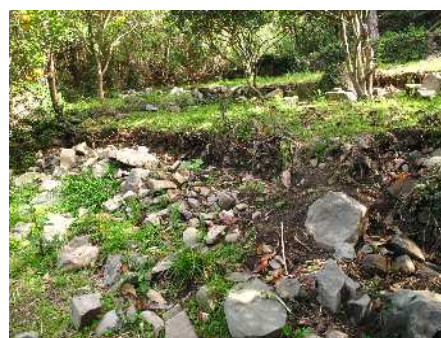
猪被害による石積みの崩落（奈留島）
