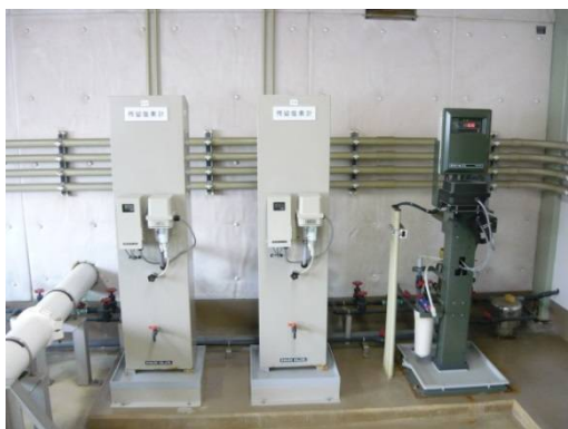
残留塩素計、濁度計
