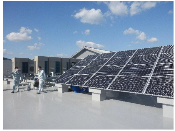
写真 7 屋上ソーラパネル設置状況
